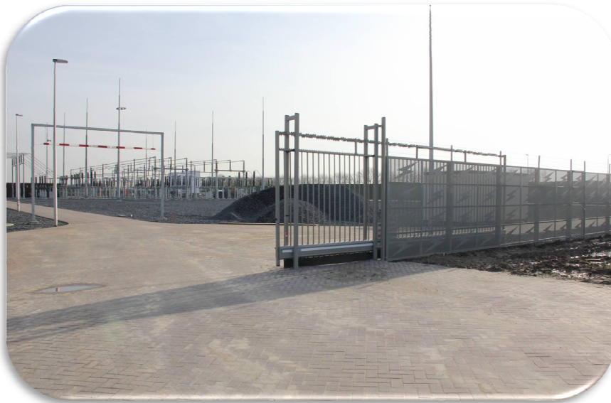
Het 150/20kV station, gelegen in het glastuinbouwgebied
